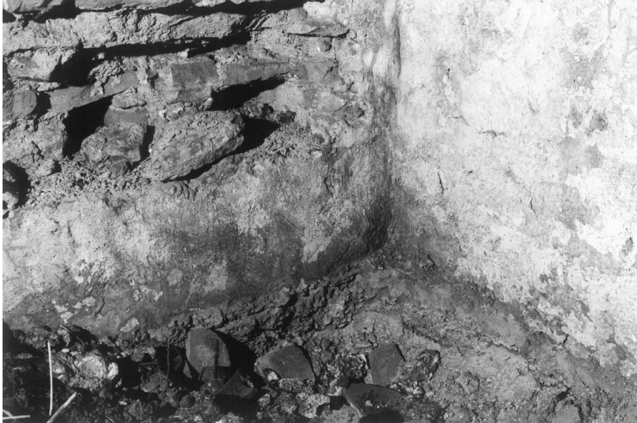
Hrobka Martina Primuse byla zničena pravděpodobně již za rekatolizačních zásahů v 17. století. Ve východní části jižní a severní stěny najdeme výklenky pro zachycení már, dobře zřetelné, i když částečně poškozené. Foto: Jan Pospíšil.
